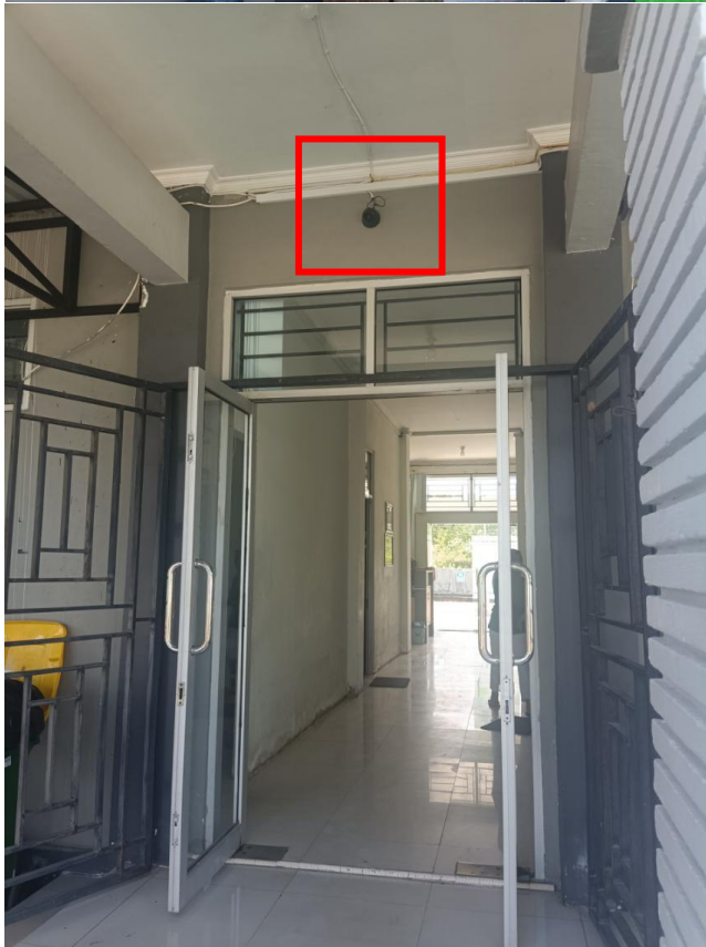
CCTV area parkir roda dua belakang
