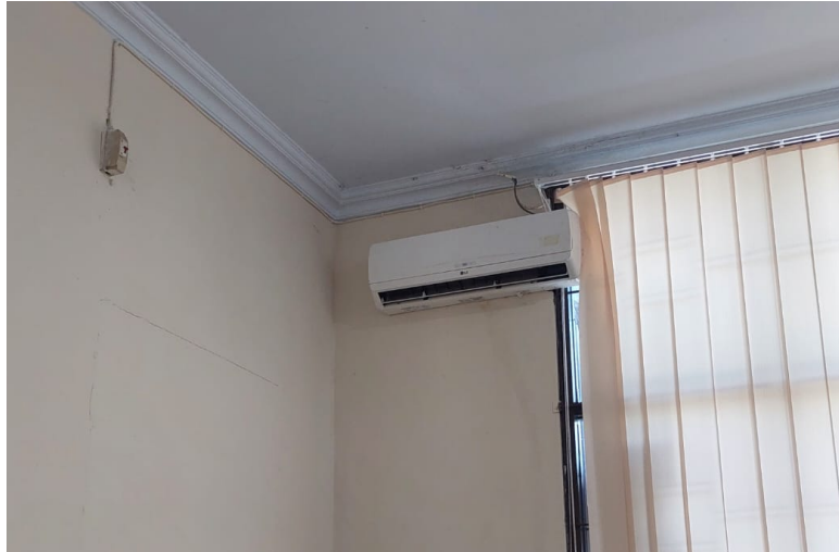
Pendingin Udara/Ac di Ruang Kolaborasi
