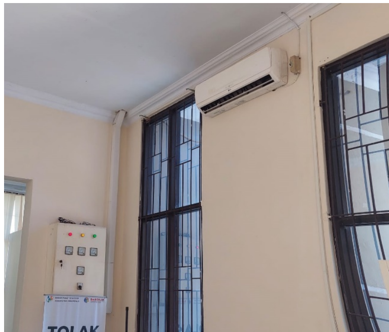
Pendingin Udara/Ac di Ruang Tunggu
